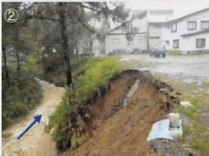
H23.8 台風12号豪雨による増水水状況
